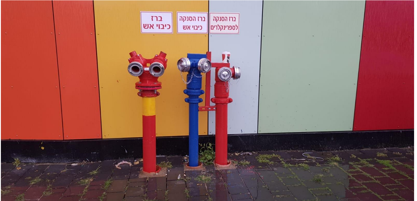
תמונה מס' 19: ברזי הסנקה להידרנטים ומתזים ממוקמים סמוך לבית קפה ברח' לבקוביץ.
