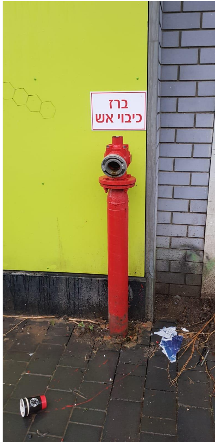
תמונה מס' 5: ברז כיבוי אש "3 סמוך לכניסה מס' 6 ברח' בילו.
