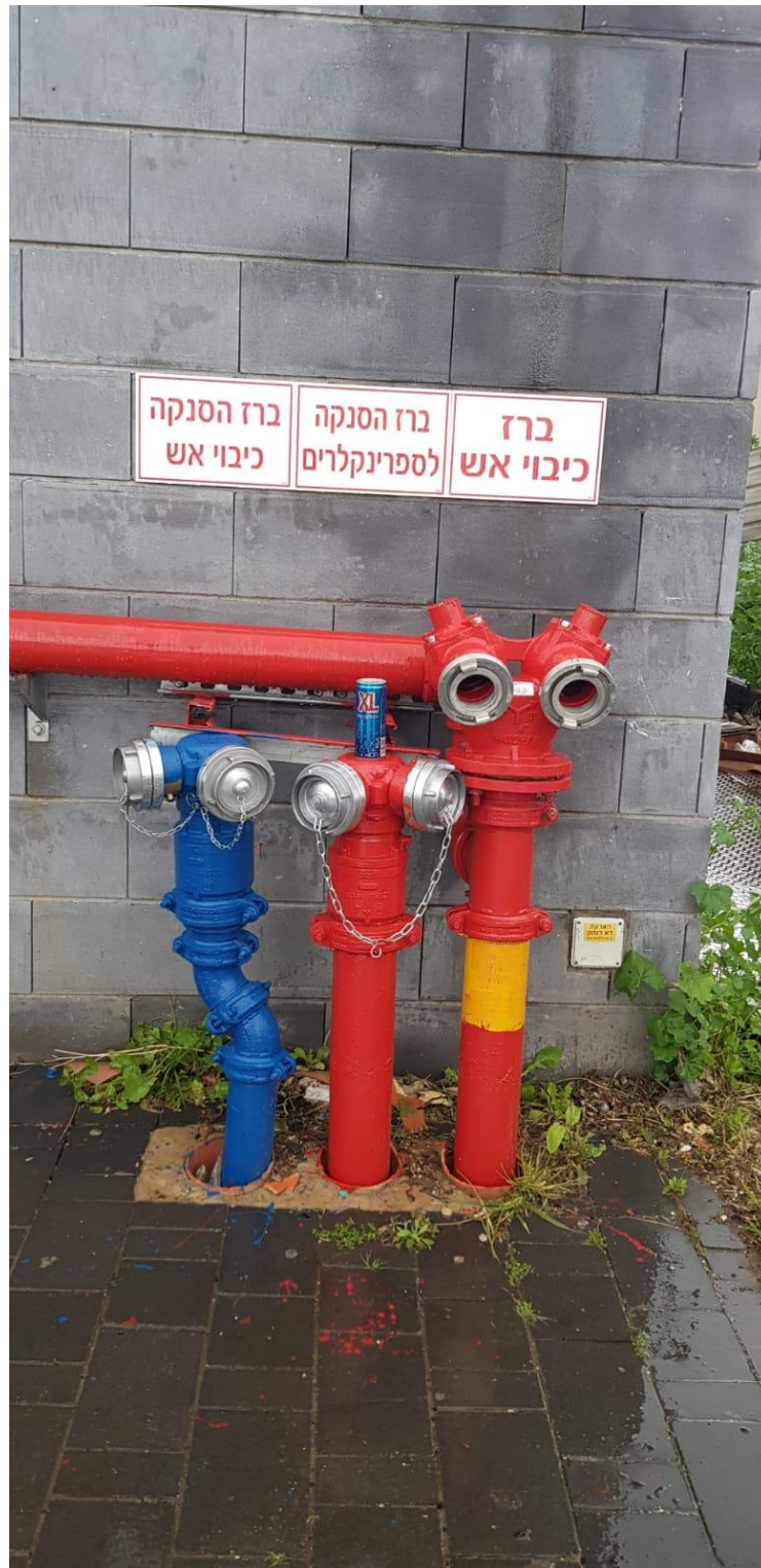
תמונה מס' 20: ברז הסנקה להידרנטים ומתזים ממוקם סמוך לברז מים ראשי ברח' לבקוביץ.
