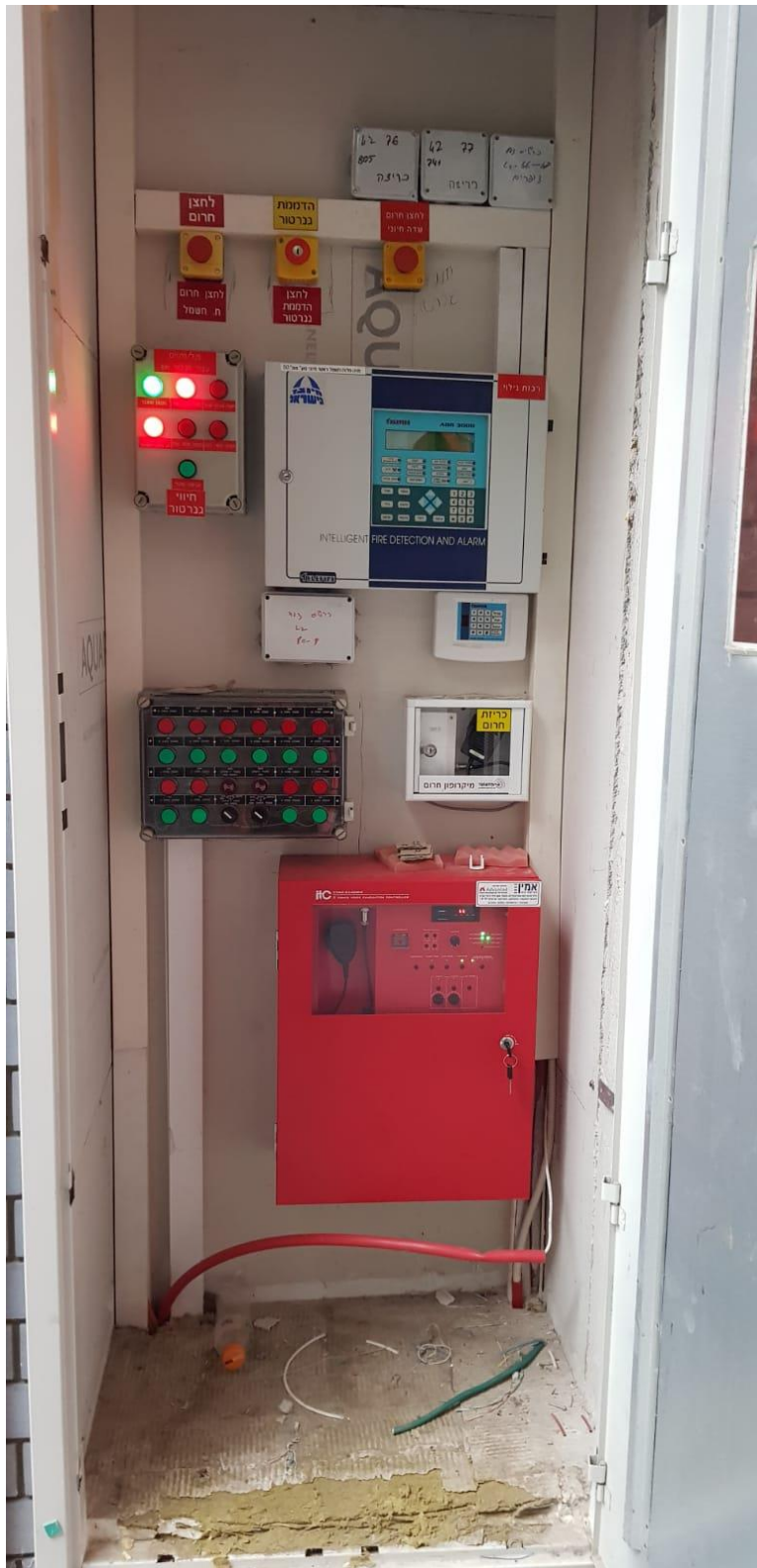
תמונה מס' 30: פאנל כבאים ממוקם בקומת הקרקע סמוך לכניסה הראשית למבנה.
