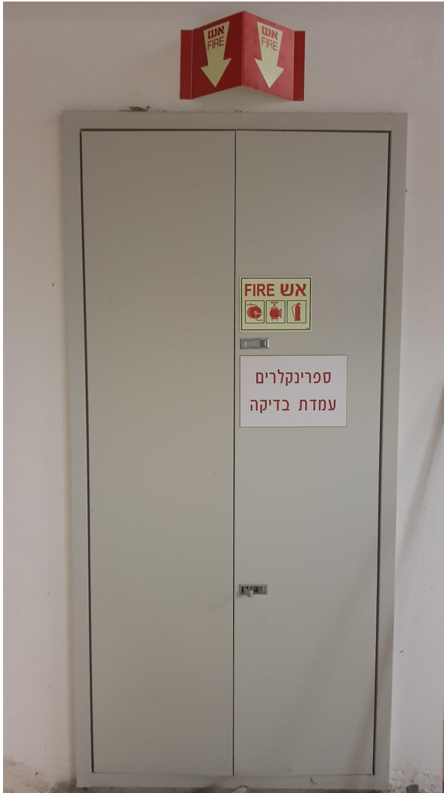
תמונה מס' 11: עמדת כיבוי אש מלאה בחניון סמוך לדלת כניסה למבואת חניון.
