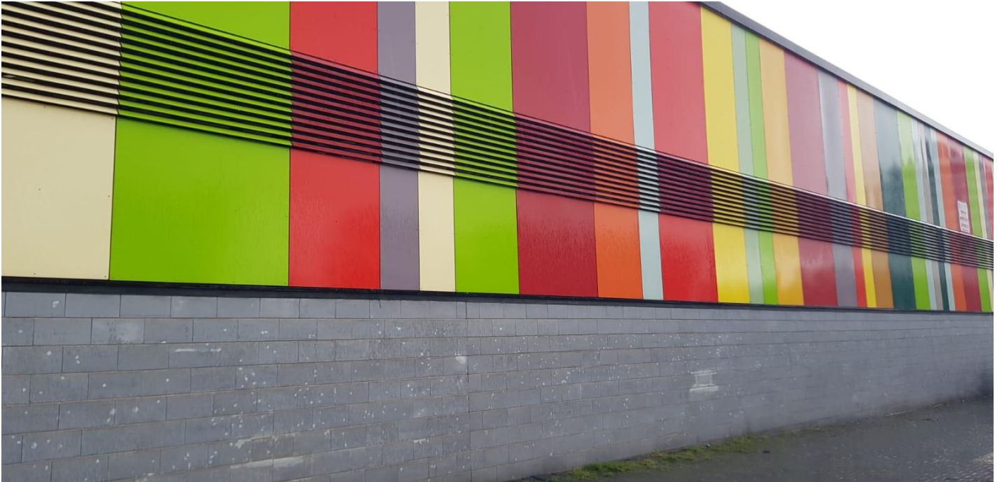
תמונה מס' 25: שחרור עשן מכל קומת המסחר מתבצע באופן טבעי ע"י רפפות בחזית המבנה.
