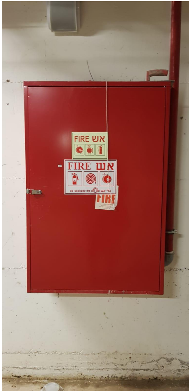
תמונה מס' 12: עמדת כיבוי אש מלאה בחניון סמוך לחדר חשמל.
