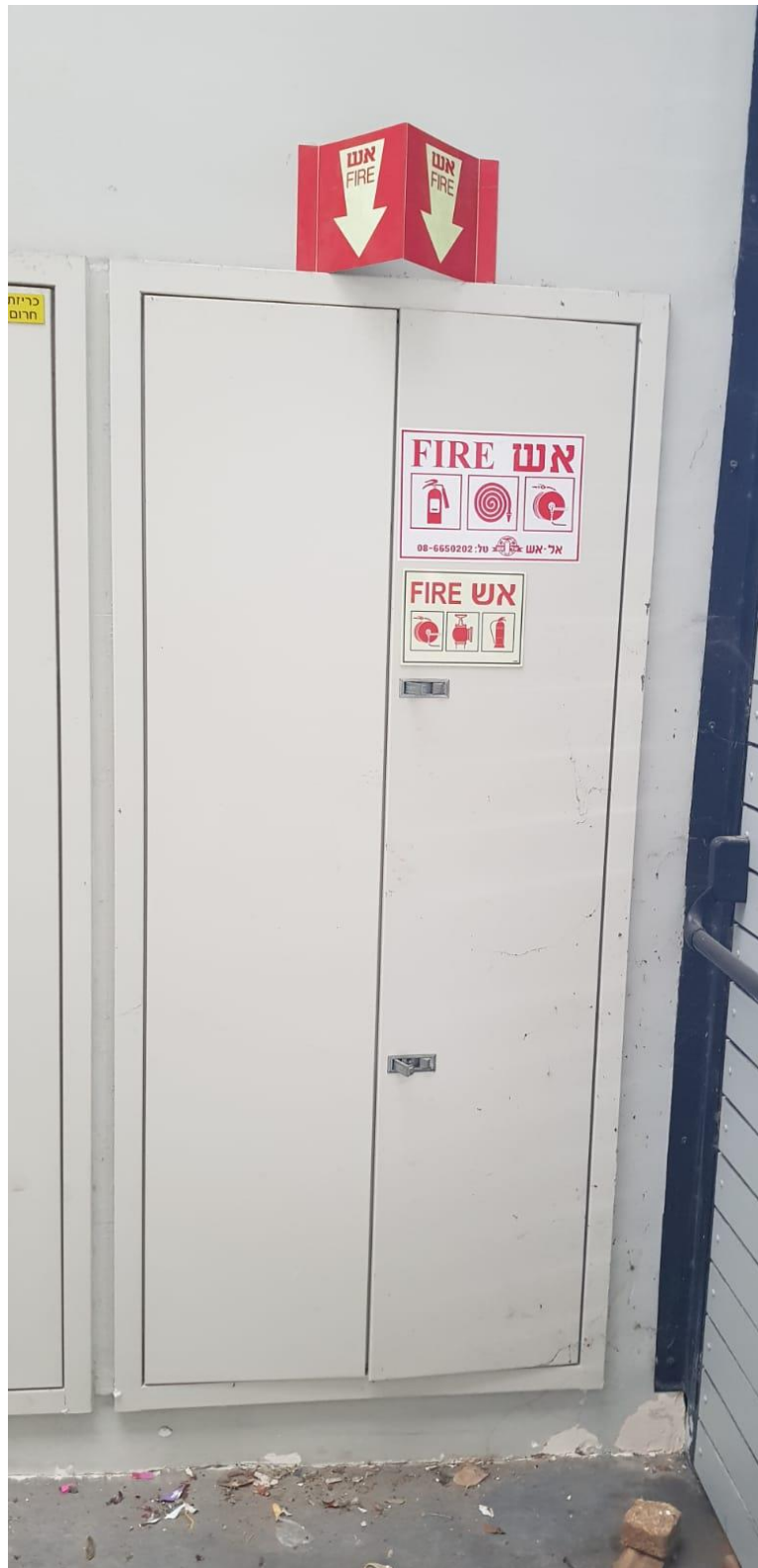
תמונה מס' 13: עמדת כיבוי אש מלאה סמוך לכניסה מס' 6 בקומת קרקע.
