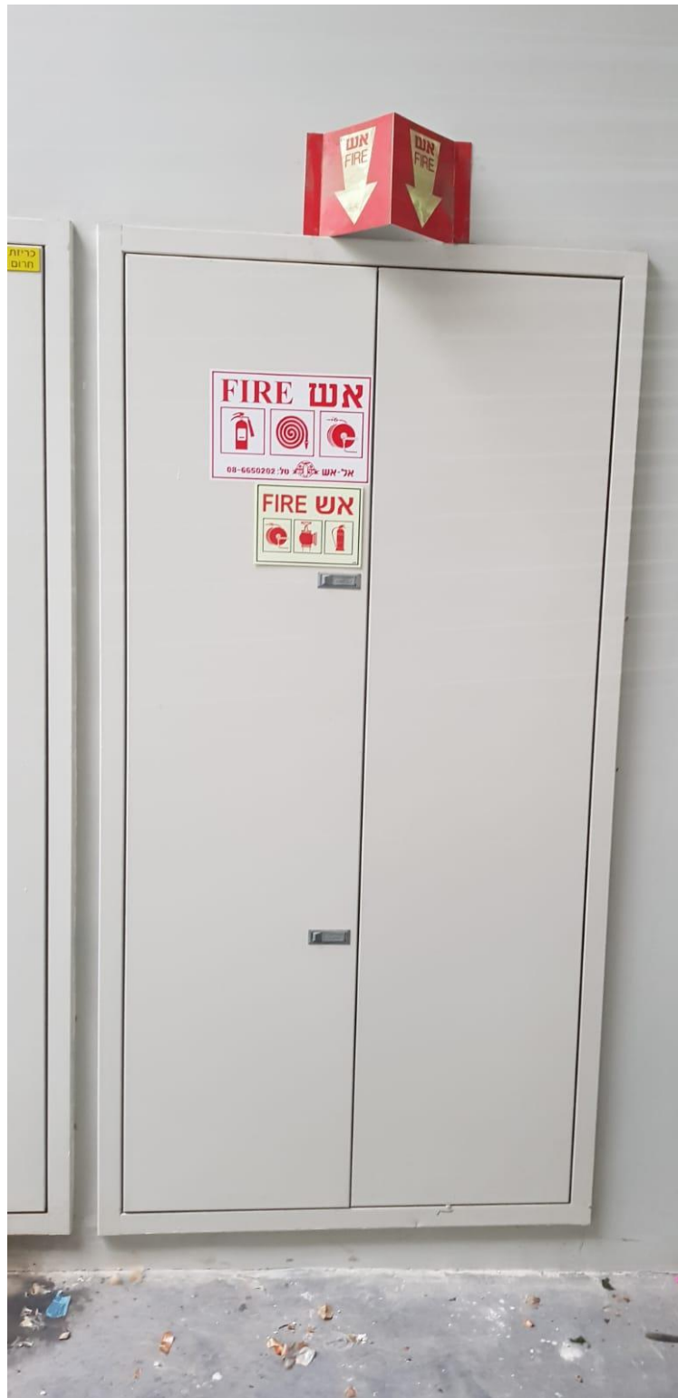
תמונה מס' 14: עמדת כיבוי אש מלאה סמוך לכניסה מס' 4 בקומת קרקע.
