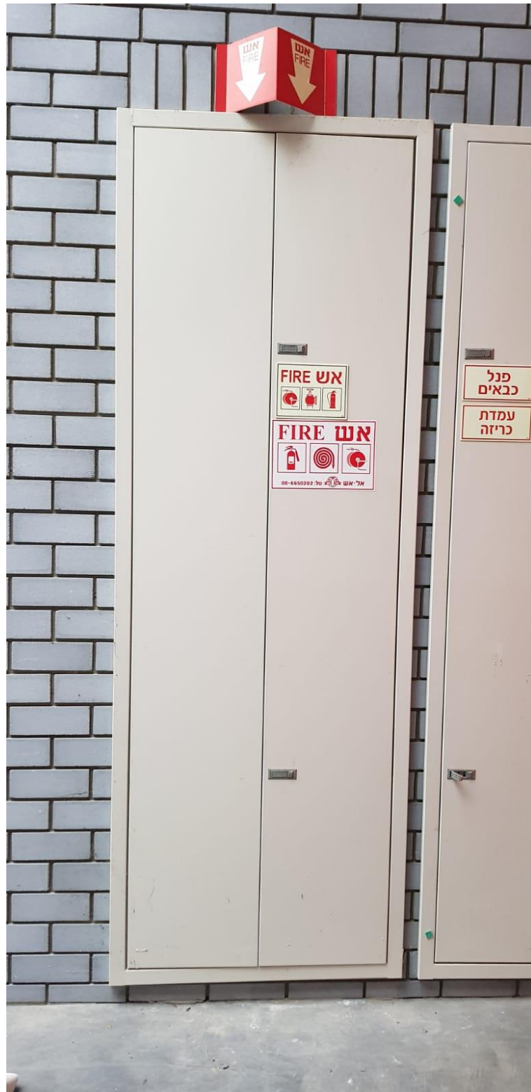
תמונה מס' 15: עמדת כיבוי אש מלאה ממוקמת סמוך לכניסה מס' 1.
